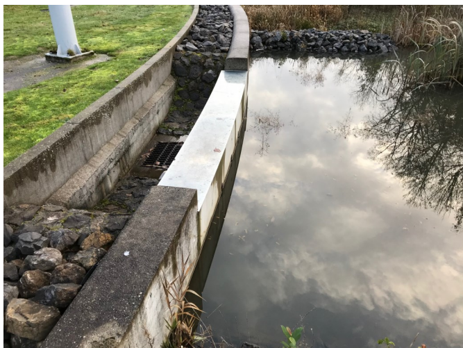
Exemple de surverse de sécurité
